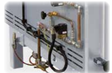
Gasleiding en thermo-element aan de voorlader
